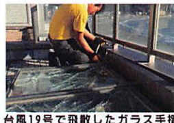
台風19号で飛散したガラス手摺
